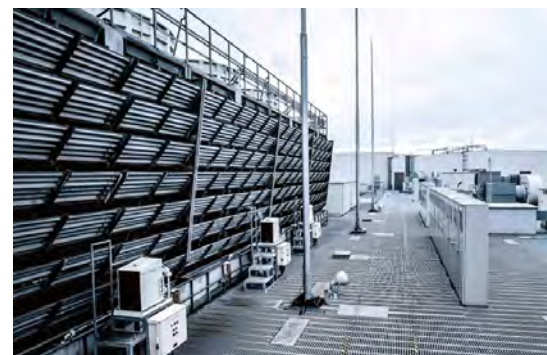
データセンターの冷却塔
