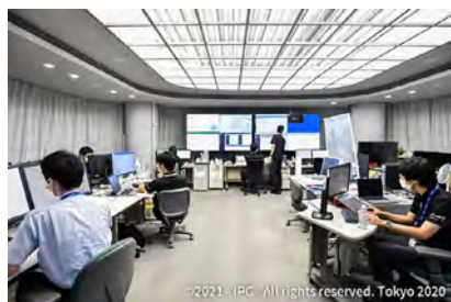
24時間体制でセコム機器の正常な稼働をサポート（セコムTEセンター内の技術サポートセンター）
