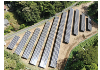
セコム専用の太陽光発電所
