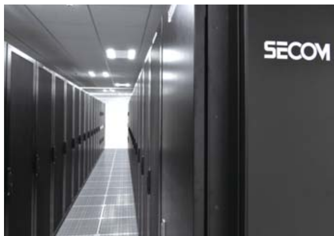
セコムのデータセンター
