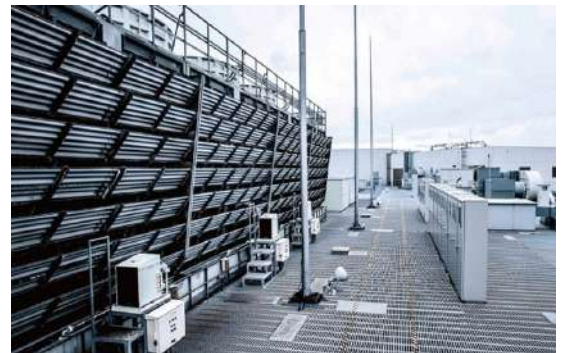
データセンターの冷却塔
