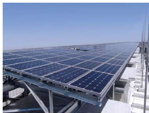
データセンターのソーラーパネル
