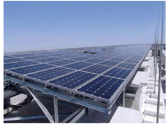
データセンターのソーラーパネル
