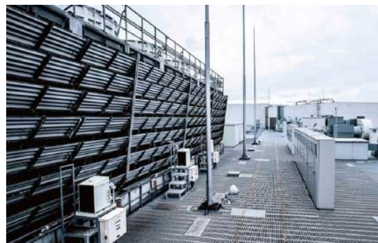
データセンターの冷却塔
