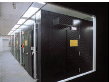
セキュアデータセンター
