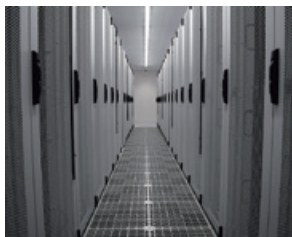
サーバーラックが立ち並ぶ 「アット東京九州第1センター」
