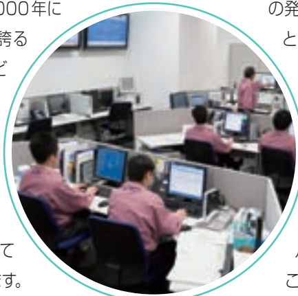
「セキュアデータセンター」新館の監視室
