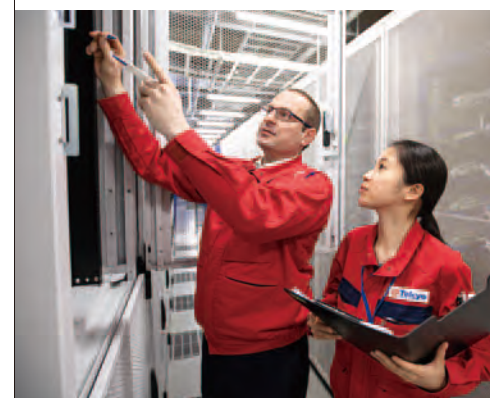
アット東京のデータセンター
