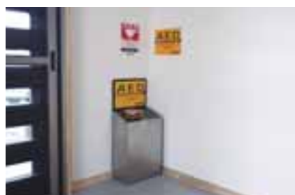
熊本地震被災地の仮設住宅に設置したセコムのAED
