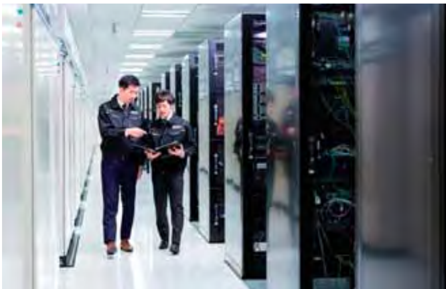
セコムのデータセンター
