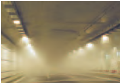
トンネルの水噴霧設備（能美防災）
