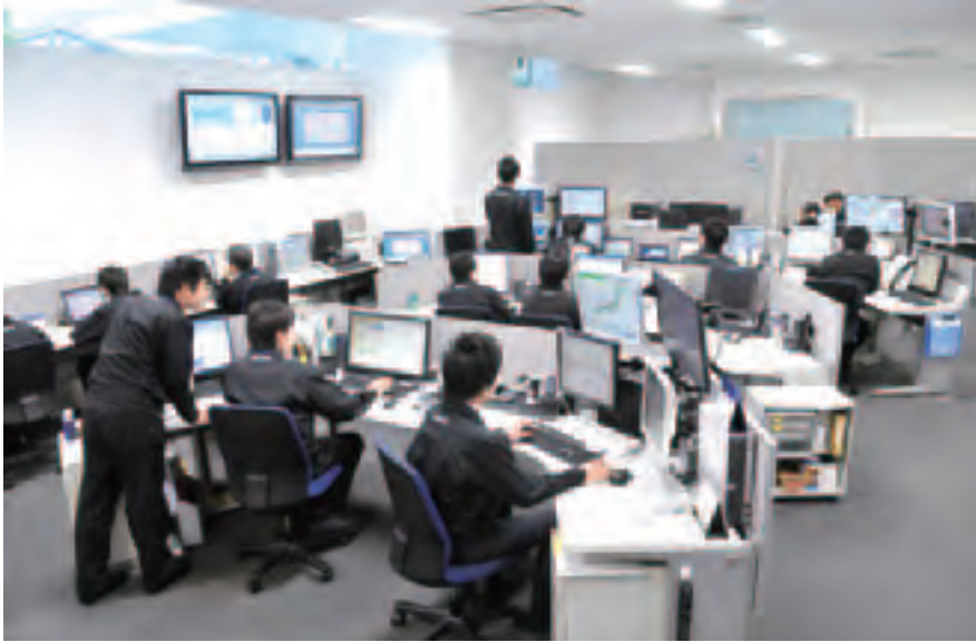
「セキュアデータセンター」の監視センター
