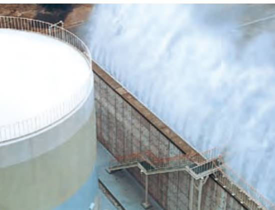
タンクヤードの水幕設備
