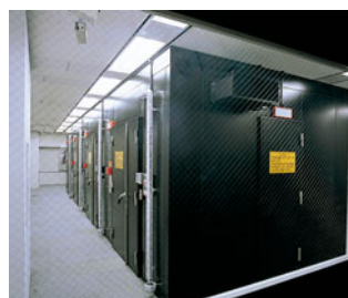
「セキュアデータセンター」
