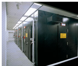
「セキュアデータセンター」
