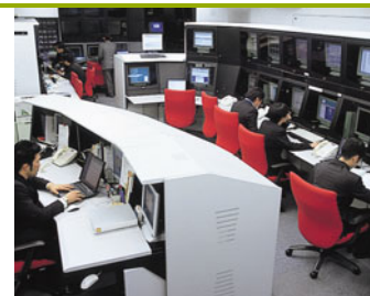
ネットワーク監視センター
