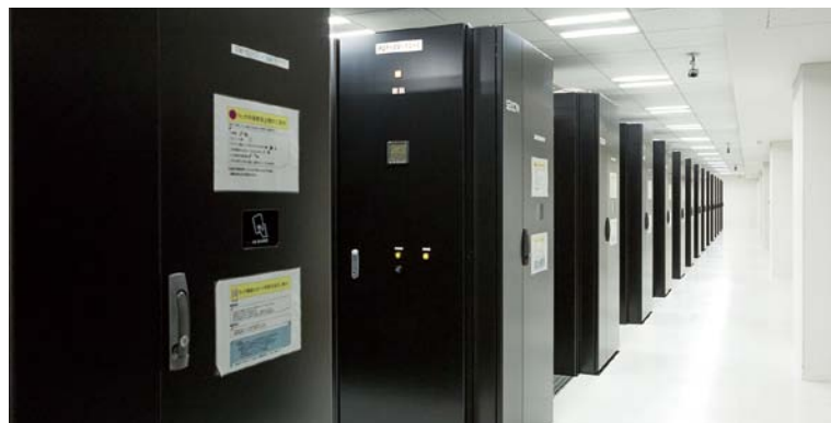
国内最高水準のセキュリティと堅牢な設備を備えた「セキュアデータセンター」
