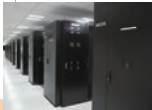
セコムが運営する堅牢なセキュアデータセンター
