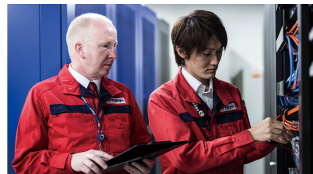
アット東京のデータセンター
