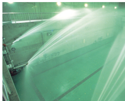
放水試験(能美防災)
