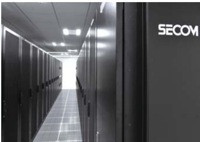
セコムのデータセンター
