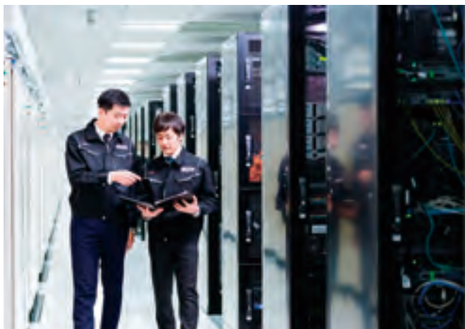
セコムのデータセンター
