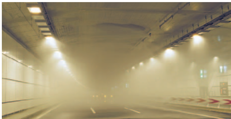
トンネルの水噴霧設備
