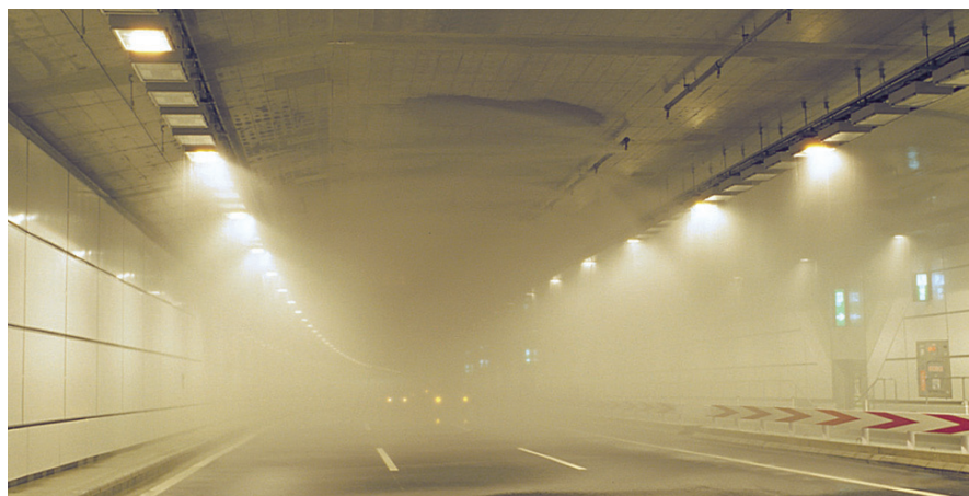
トンネルの水噴霧設備
