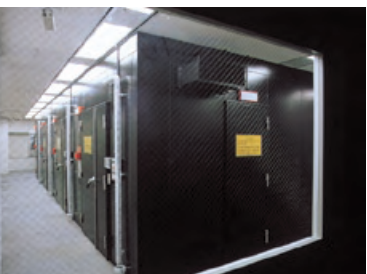
セキュアデータセンター
