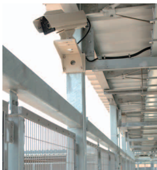
センター内に設置されたCCTVシステム
