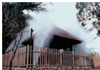
文化財に設置された消火設備
